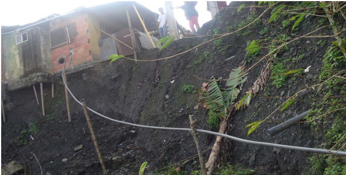
Fotografía No. 1: Nótese la construcción sobre el talud inestable, la poca cobertura vegetal del terreno y apalancamiento de la base soporte de la casa
