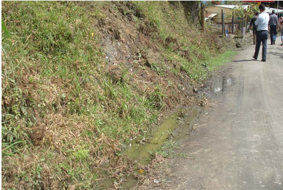
Fotografía No. 2: Se observa la falta de obras de arte y empozamientos del agua sobre la vía generando infiltración
